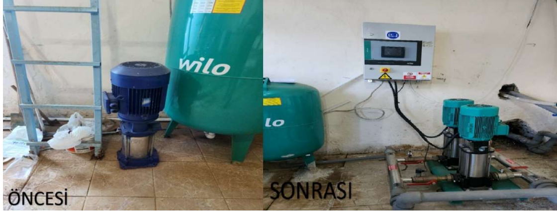
Görsel 12 Su pompasına invertör uygulaması
